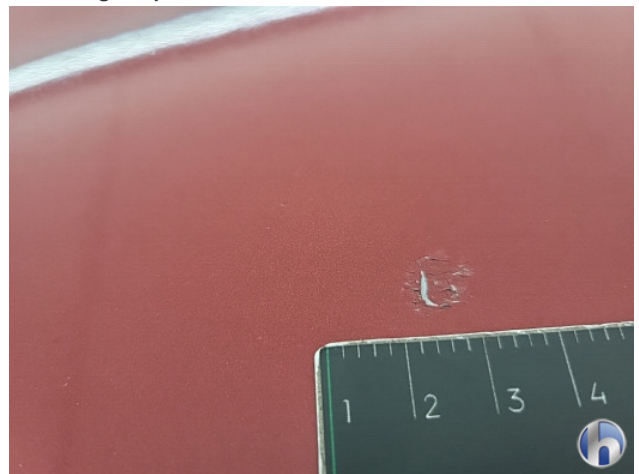
2. lakonthechting Beschadigd - Spuiten
