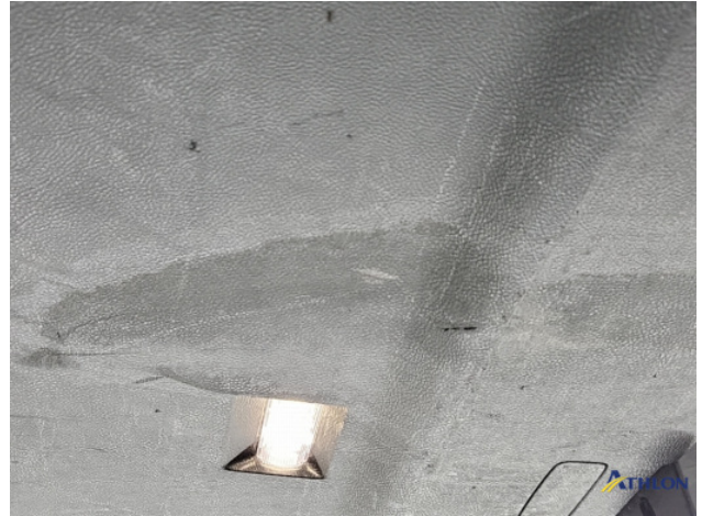
7. diverse interieur Beschadigd
