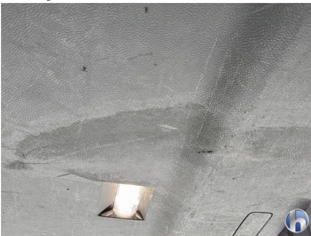
3. diverse interieur Beschadigd - Vernieuwen
