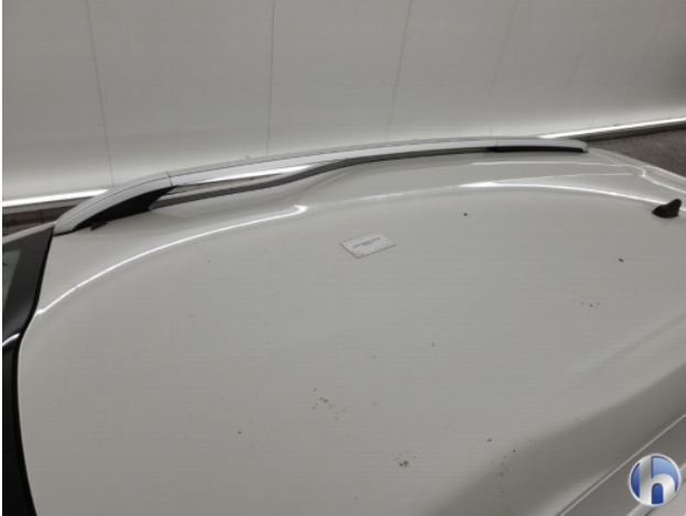
1. Dak Hagelschade - Herstellen zonder spuiten
