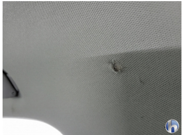
6. diverse interieur Beschadigd - Vernieuwen
