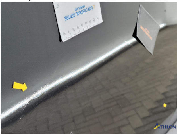
3. slecht herstel Gebruikssporen
