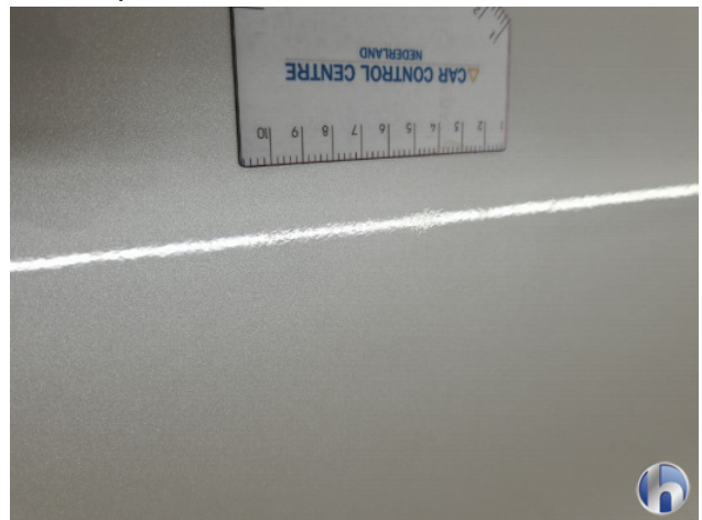
2. slecht herstel Gebruikssporen - Aanvaardbaar
