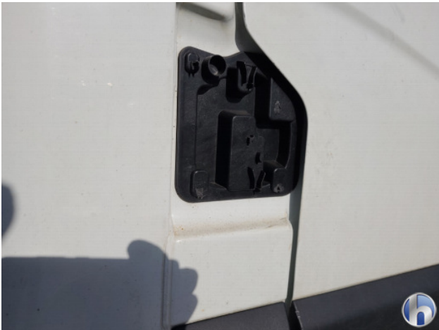
1. Portier voor - rechts Deuk/deuken - Herstellen
