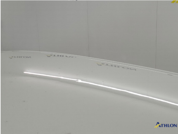
1. hagelschade dak Deuk/deuken
