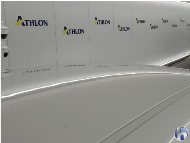
1. hagelschade dak Deuk/deuken - Herstellen zonder spuiten
