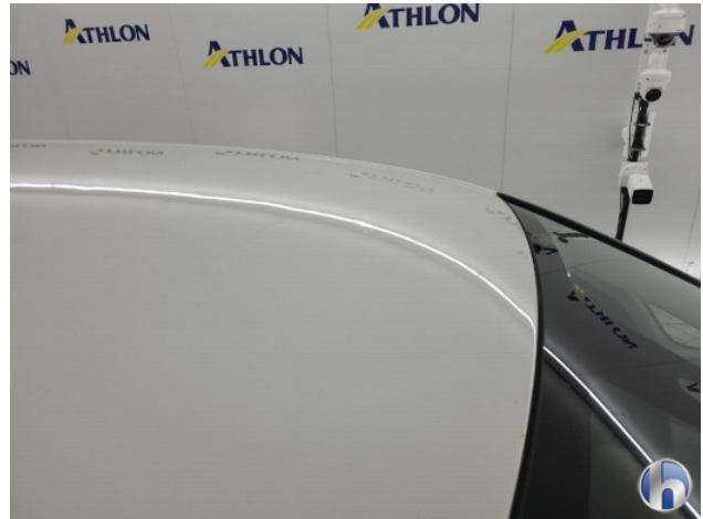
1. hagelschade dak Deuk/deuken - Herstellen zonder spuiten
