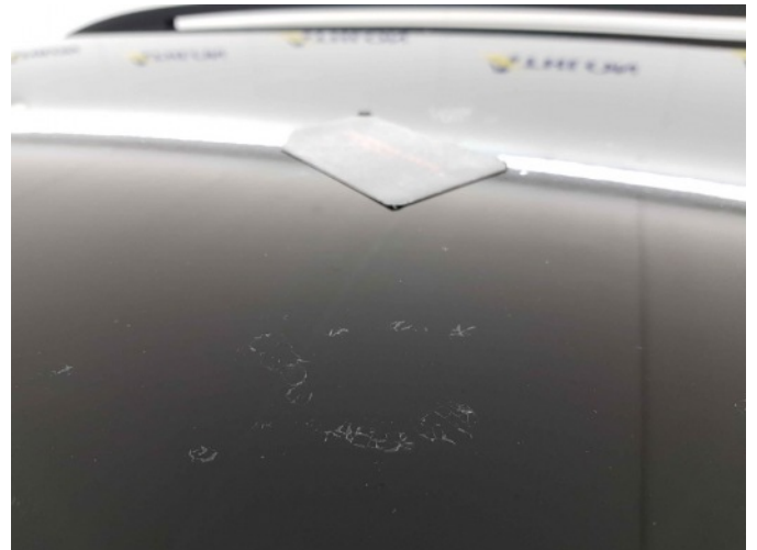
11. Ingevreten vogelpoep dak
